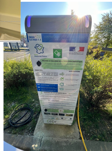
Bornes de recharge des véhicules électriques (2021)
